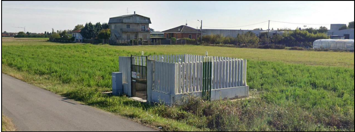
Fig. 9.1.12/B - Installazione tipo impianto di linea con recinzione con pannelli prefabbricati in cls
