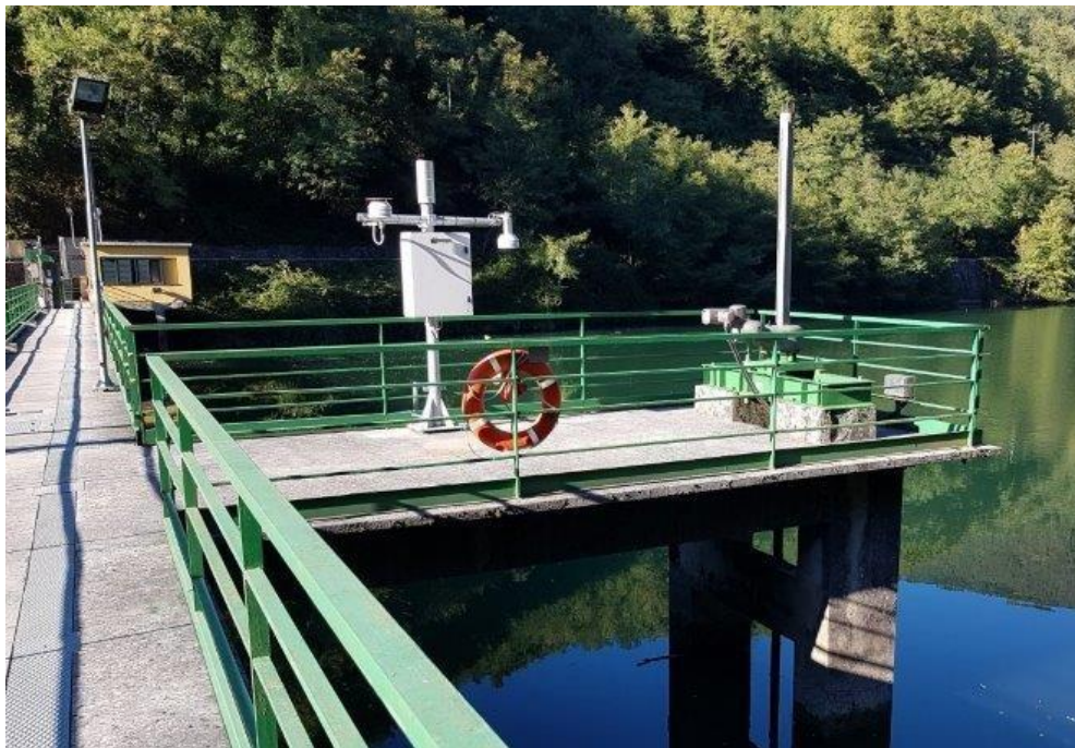
Figura 40 - Dettaglio della posizione di comando (locale), telaio in acciaio e zoccolo in c.a.
