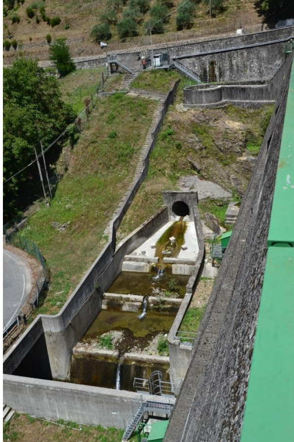
Figura 33 - Vista d'insieme del sistema di vasche di scarico del by-pass.
