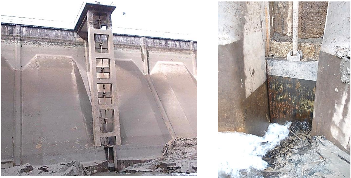
Figura 39 - Vista d'insieme dello scarico di fondo e dettaglio della paratoia.
