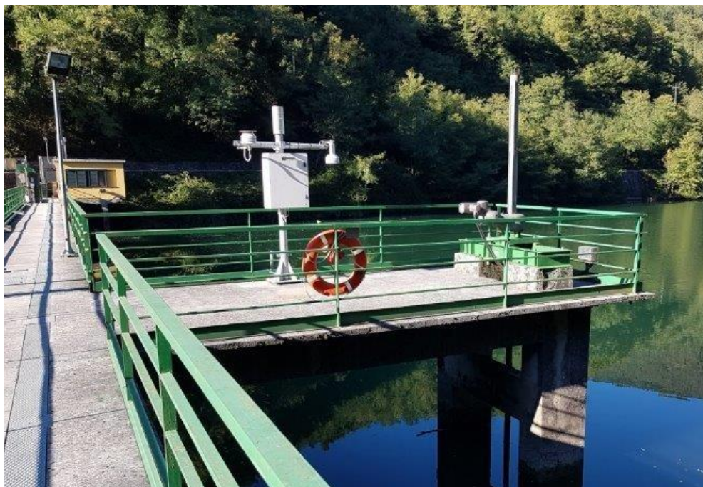
Figura 18 - Dettaglio della posizione di comando (locale), telaio in acciaio e zoccolo in c.a.
