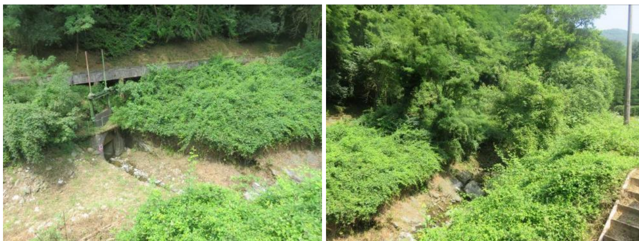
Figura 79. Roveto ruderale circondante il bypass ed il torrente immediatamente a monte dello stesso
