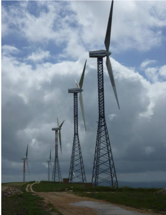
Viabilità esistente e impianti eolici da dismettere in Località Cannavale, Greci (Av).
