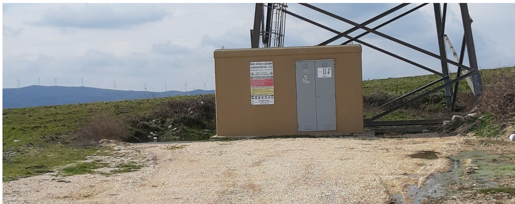
Figura 1: nella foto in alto si vedono gli aerogeneratori con torre tralicciata in esercizio, mentre nella foto in basso è raffigurata cabina prefabbricata dove è alloggiato il trasformatore e la piazzola tipo attualmente esistente.
