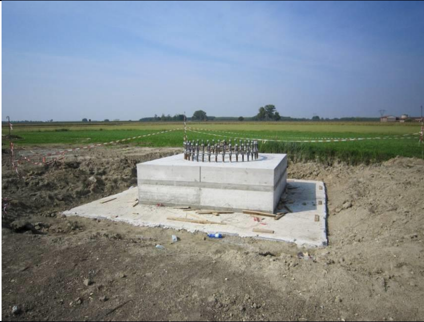
Figura 17 - Realizzazione di fondazioni superficiali tipo plinto a monoblocco per un sostegno monostelo.
