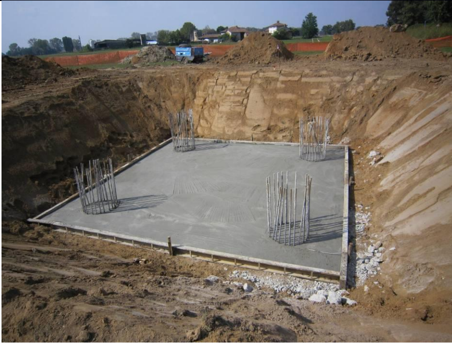
Figura 22 - Realizzazione di una fondazione su pali trivellati per un sostegno monostelo. Nell'immagine si può osservare una fondazione in fase di realizzazione. Si possono distinguere facilmente i quattro pali trivellati già realizzati e gettati (si osservano le "riprese" delle quattro gabbie metalliche) ed il piano di "magrone" sul quale impostare il monoblocco in cls
