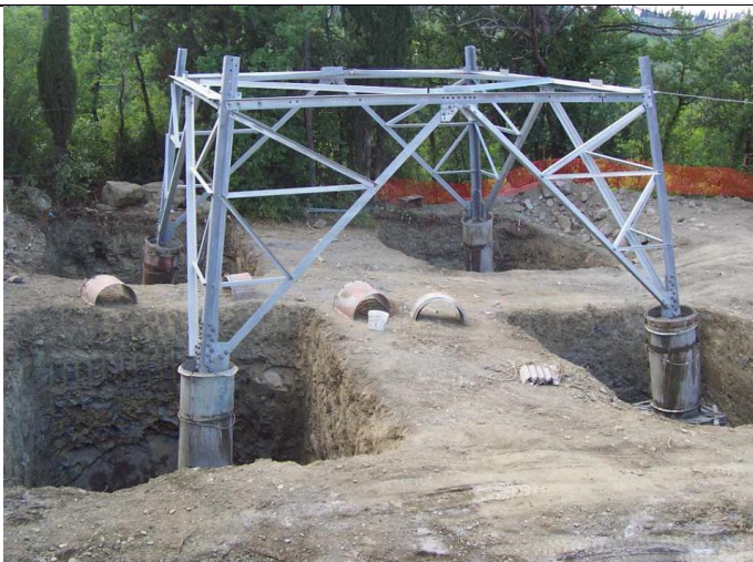
Figura 14 - Realizzazione di fondazioni superficiali tipo CR per un sostegno a traliccio. Nell'immagine si possono osservare le quattro buche, la base del sostegno collegata alla fondazione tramite i "monconi" ed i casseri utilizzati per i quattro "colonnini"
