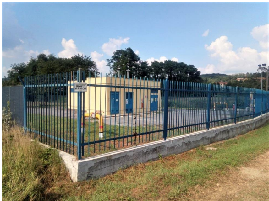
RL-7 – IMPIANTO ESISTENTE A DISTANZA DALL'INTERVENTO 6 – RIF. PIDI 4500240/33
