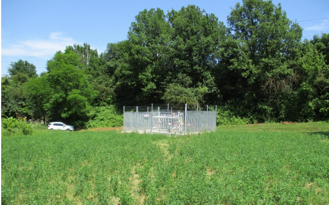
Figura 7-2 – Esempio impianto PIDI da dismettere.
