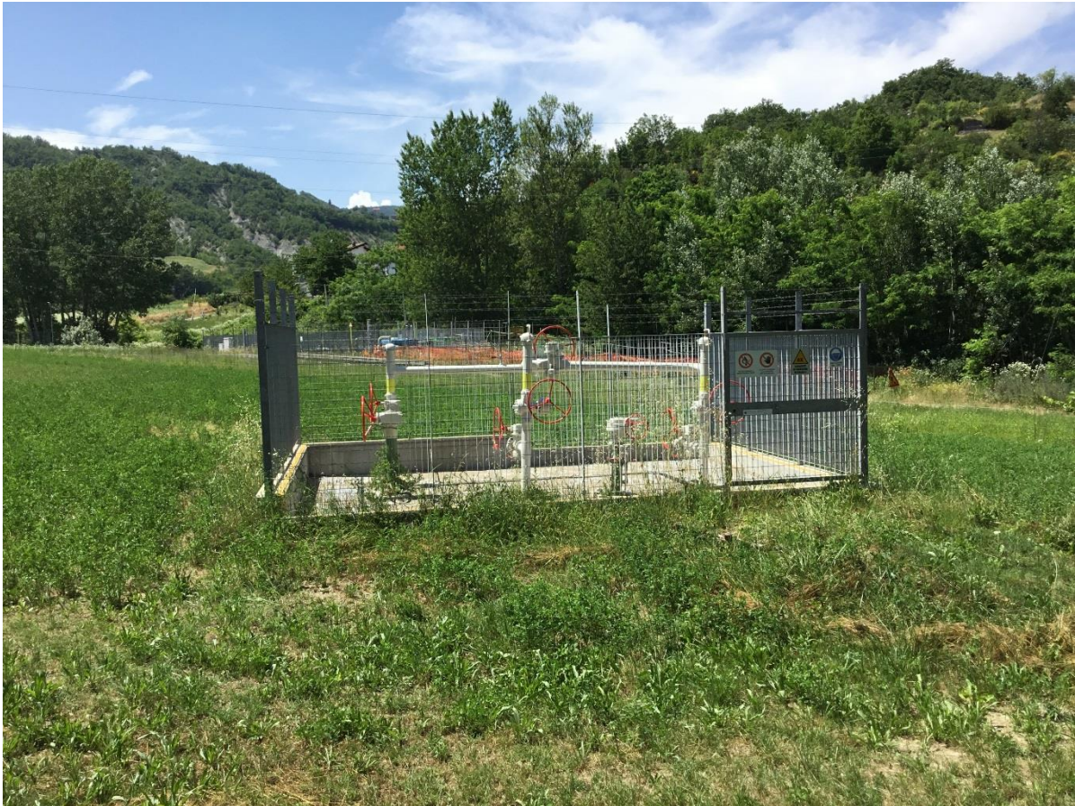
Fig. 6-4 – Foto Impianto PIDI 4500240/20.1 esistente.
