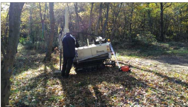
Postazione Sondaggio S13p
