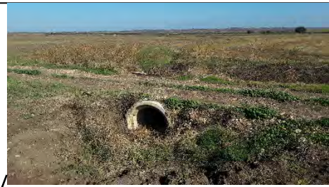
Tubazione bypass esistente (T1)
