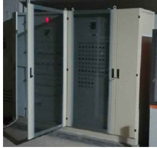
Quadro di Distribuzione Serbatoio Esistente
