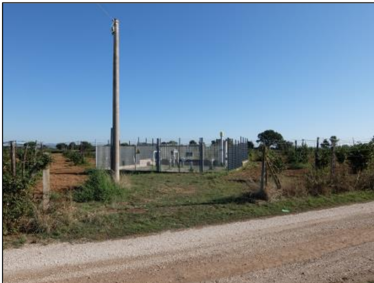
Foto 2.1.4 C – Impianto terminale n° 4104239/5.1
