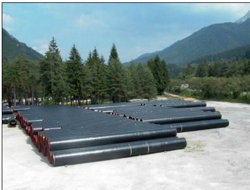
Fig. 5/A: Piazzola di accatastamento tubazioni
