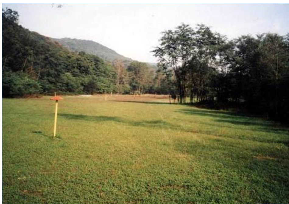
Fig. 5/K – Pista di lavoro ad opera ultimata su un gasdotto in esercizio
