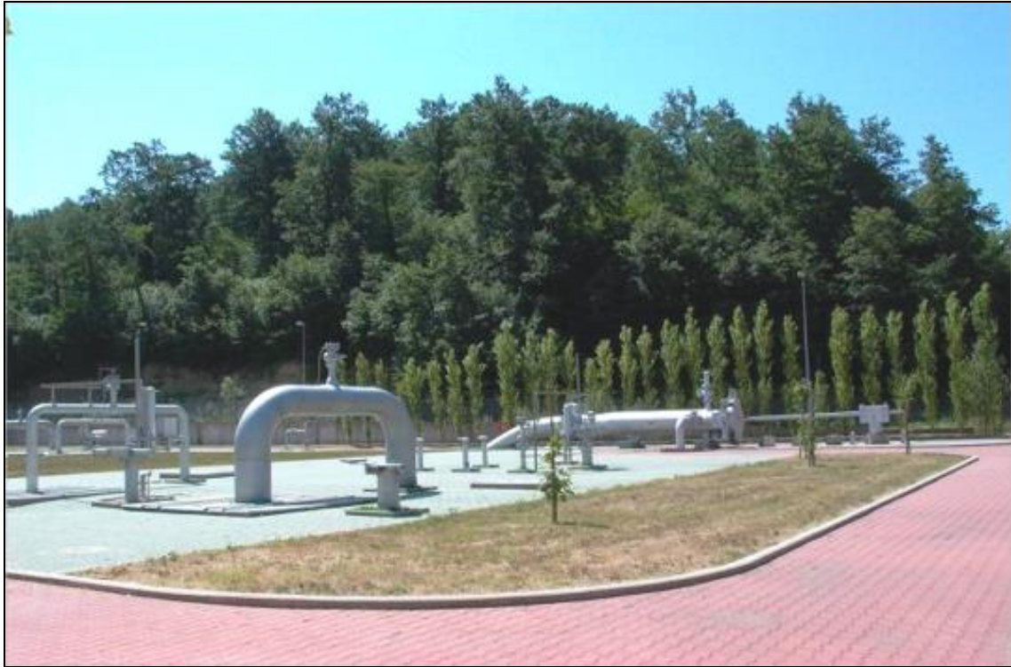
Fig. 5.1.12/B: Installazione tipo stazione di lancio e ricevimento PIG
