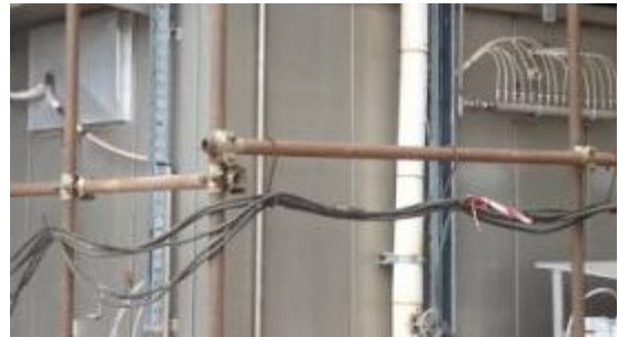
FIGURA 3 - UTILIZZO DI GANCI PER SOLLEVARE I CAVI ELETTRICI
