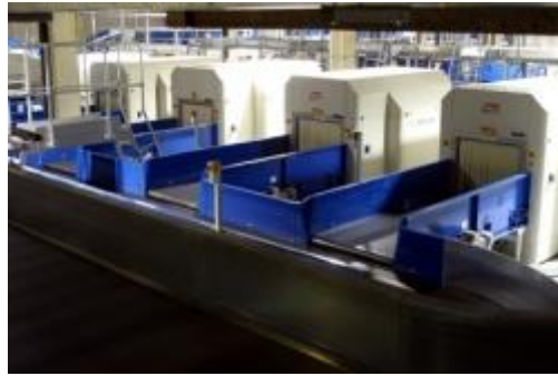
Figura 57: Macchine screening del sistema movimentazione bagagli (HBS)
