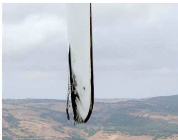
Figura 13 estremità di pala danneggiata da fulminazione atmosferica
