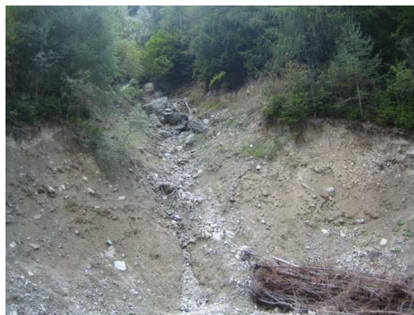
Colata detritica alla base del versante
