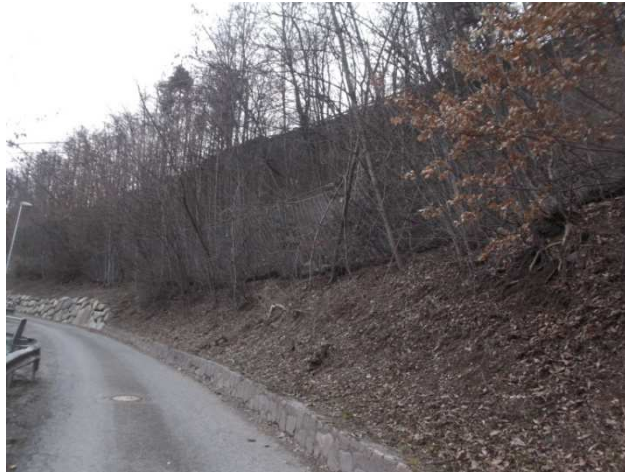
Rete paramassi lungo la scarpata sopra la strada di accesso al cantiere
