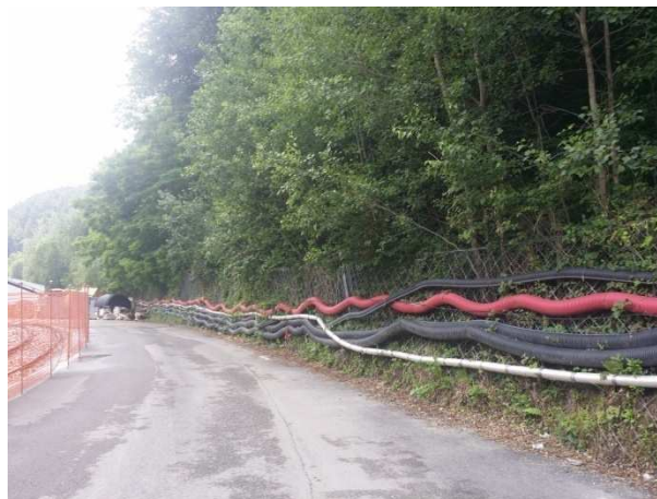
Steinschlagschutznetze am Fuß des Hanges / Rete paramassi ai piedi del versante
