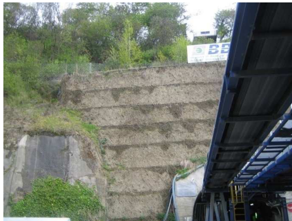
Steinschlagschutzbarrieren über dem Nordportal Barriera paramassi sopra il portale nord
