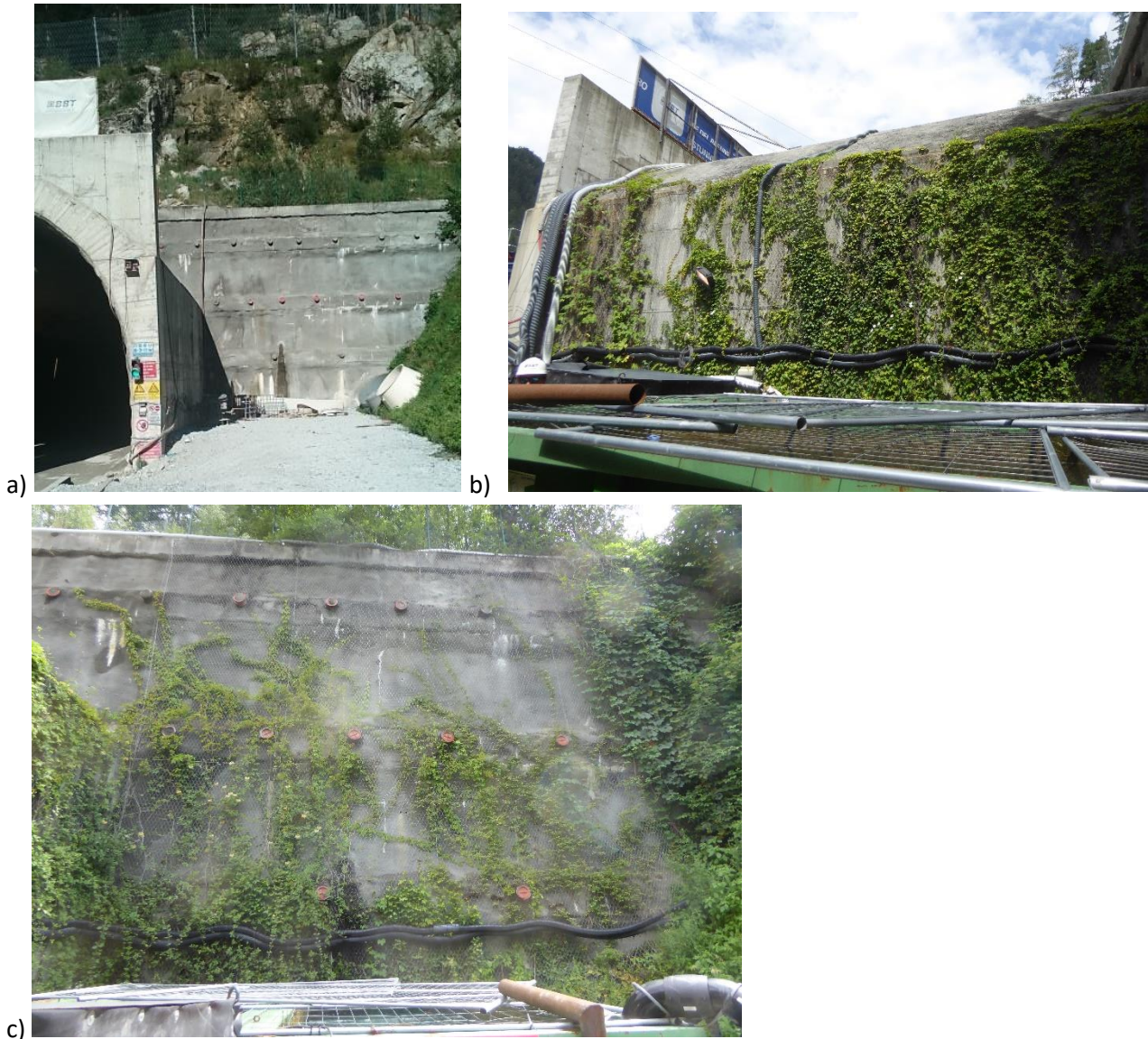
Figura 8: portale di Mule: a) prima dell'intervento, b) e c) luglio 2019
