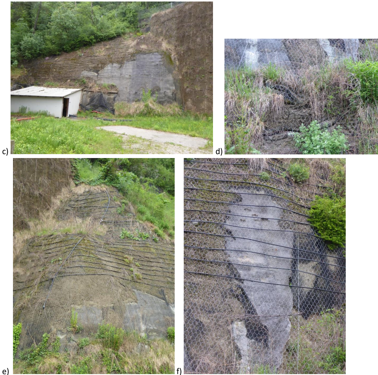
Figura 4: situazione ante-operam: a) portale, b) particolare della griglia e dello stato del terreno di riempimento, c) scarpata laterale con inerbibimento fallito, d) scivolamento della geotexte, e) scarpata a destra del portale priva di vegetazione vitale, f) particolare della rottura della geotexte.
