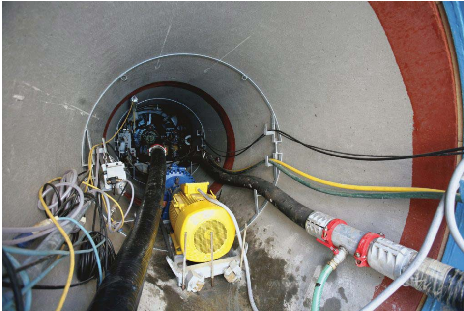
Figura 4.1 – Cavi elettrici ed idraulici di alimentazione fresa. Si noti l'installazione della pompa centrifuga necessaria per l'evacuazione del materiale di smarino.
