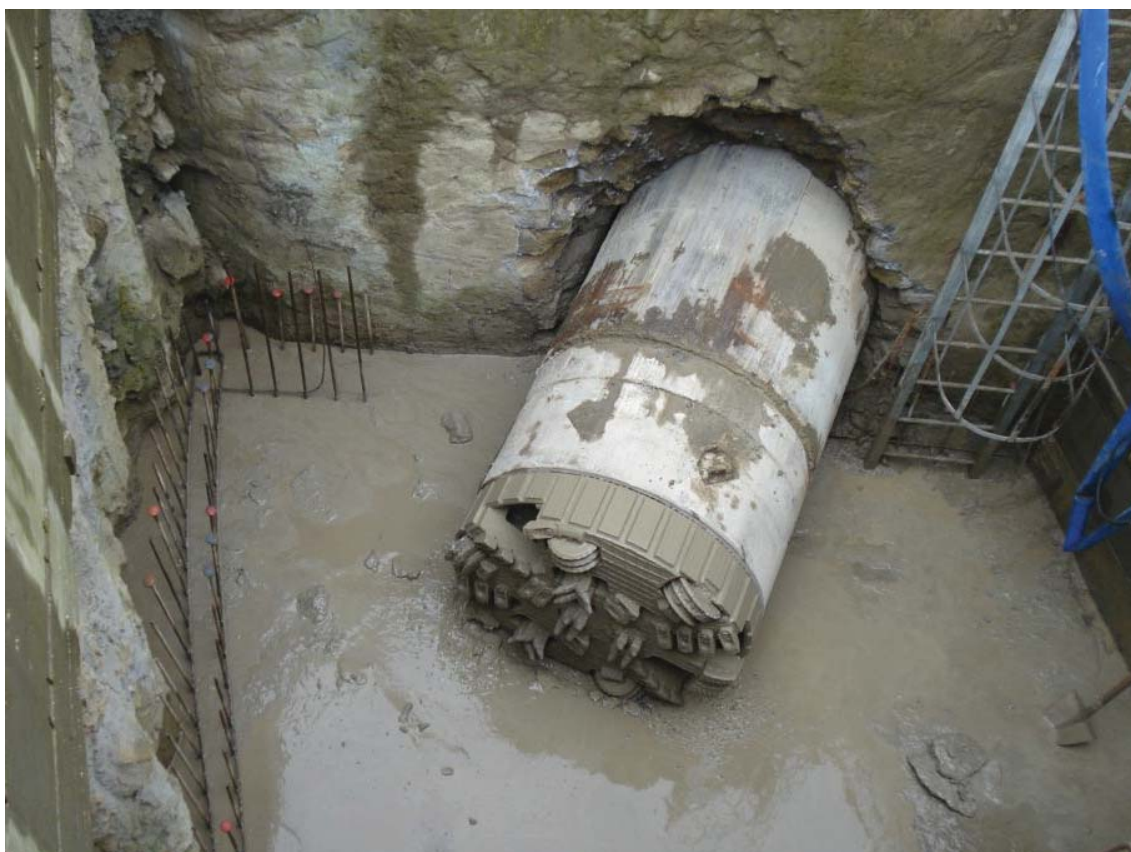
Figura 5.1 – Microtunneler all'interno del pozzo di uscita (tratto dal sito Web La Falce – Posa in opera di condotta in c.a. DI 1600 mm DE 1940 mm – Cliente Co.ge.pa. S.r.l. – Sistema Adduttore Acquedotto Vesuviano).
