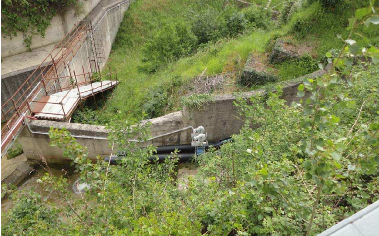
Figura 14 – Punto di rilascio degli scaricatori
