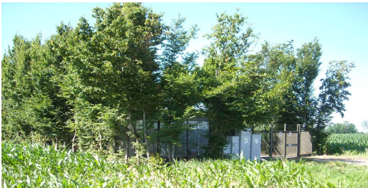
Foto 2.N: Esempio di mascheramento di impianto di linea
