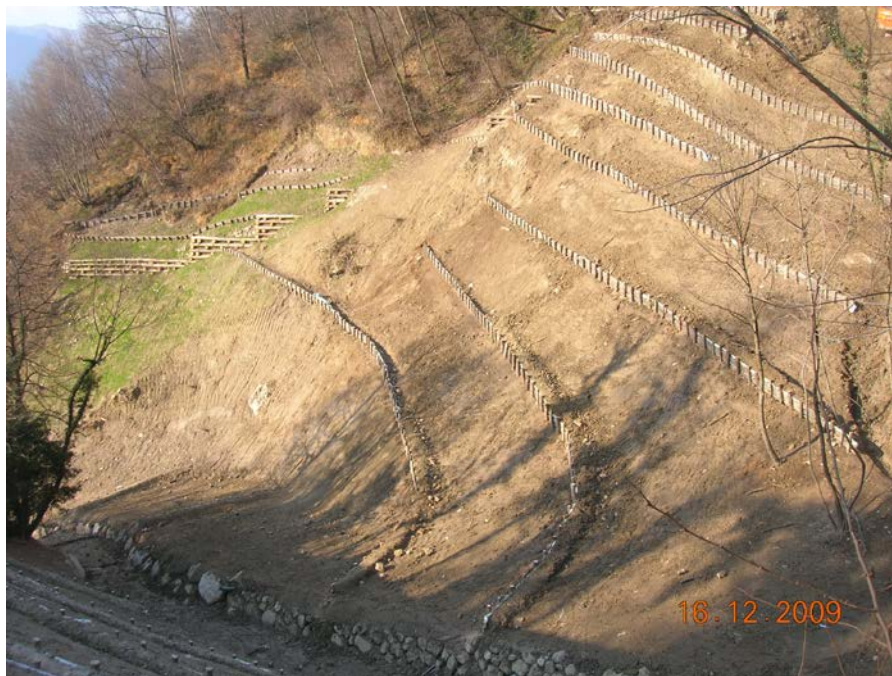
Foto 2.L: Esempio di ripristino morfologico e consolidamento di un versante con opere di ingegneria naturalistica (palizzate e palificate)
