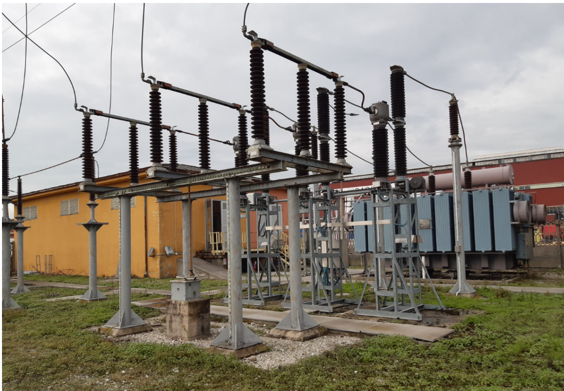
Figura 12 Connessione in Alta Tensione alla rete Terna in AT
