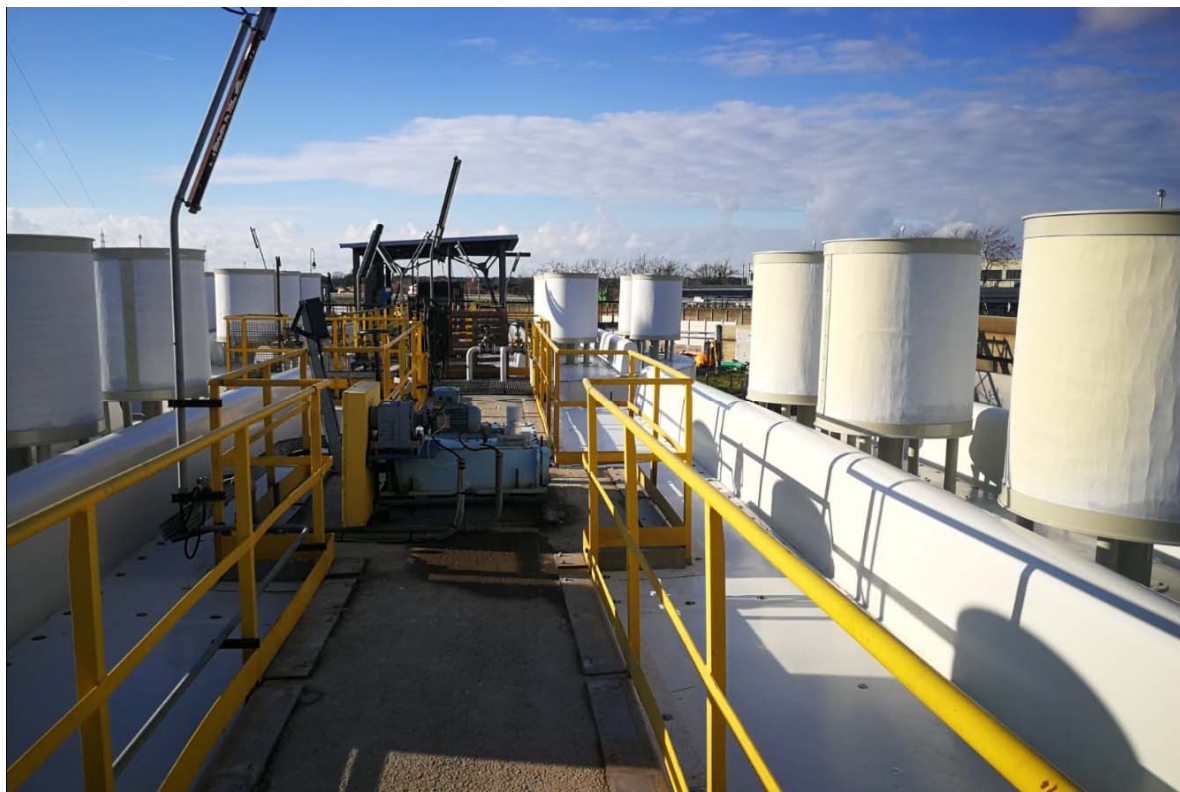
Figura 5 – Particolare della disposizione dei filtri, lateralmanete al camminamento sopra gli ispessitori
