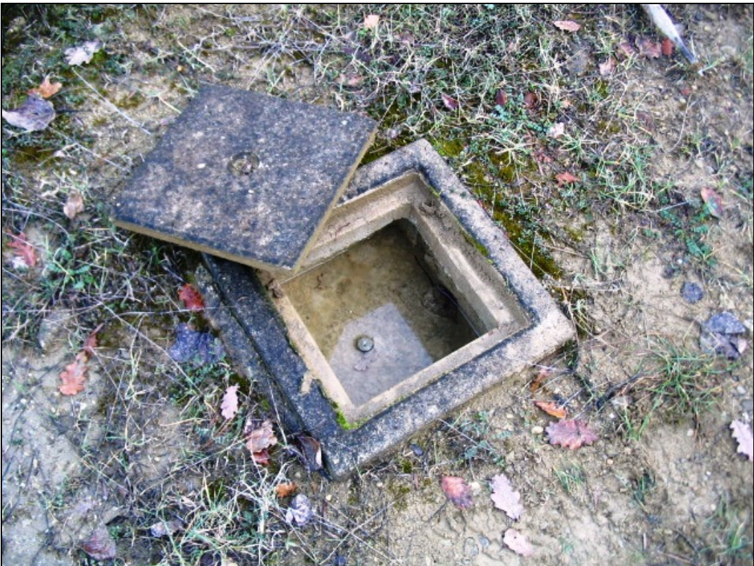
Figura A-12 –Pilastrino di misura sul coronamento della diga.
