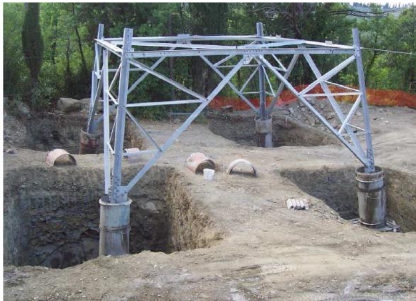
Figura 2-8 Realizzazione di fondazioni superficiali tipo CR per un sostegno a traliccio, con le quattro buche, la base del sostegno collegata alla fondazione tramite monconi ed i casseri utilizzati per i quattro colonnini
