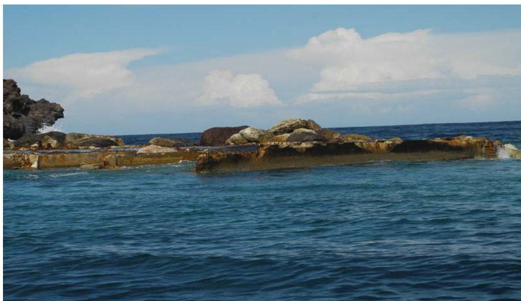
foto 4: rilievo stato di danneggiamento delle pareti dei cassoni
