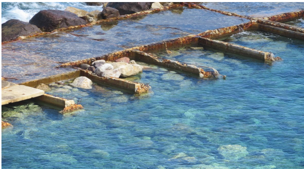
foto 3: rilievo dello stato di danneggiamento dei setti interni ai cassoni
