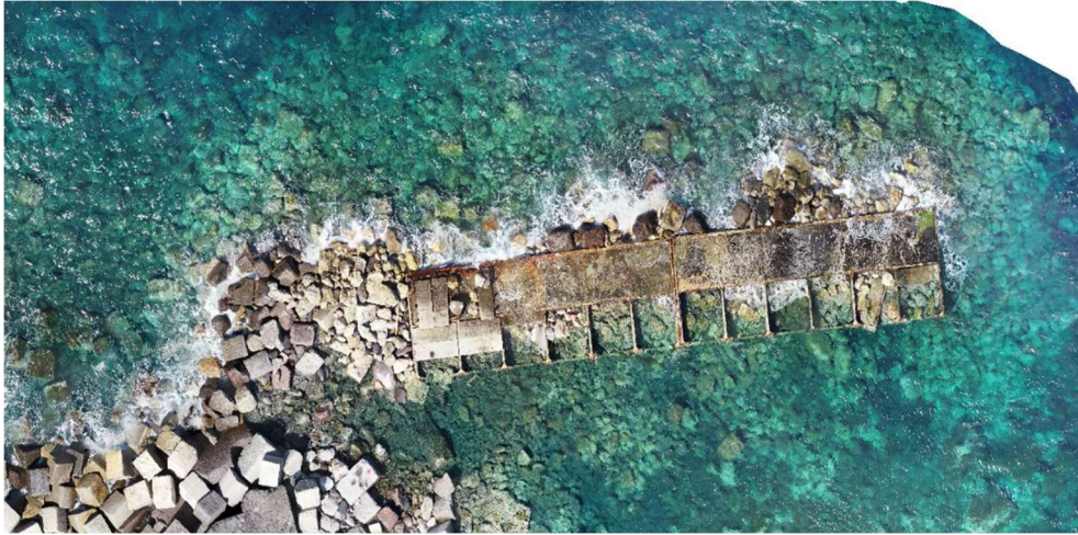
Figura 3 – Ortofoto del 10/04/19 delle opera incompiute realizzate con i lavori del 2012 - si noti il maggiore stato di danneggiamento
