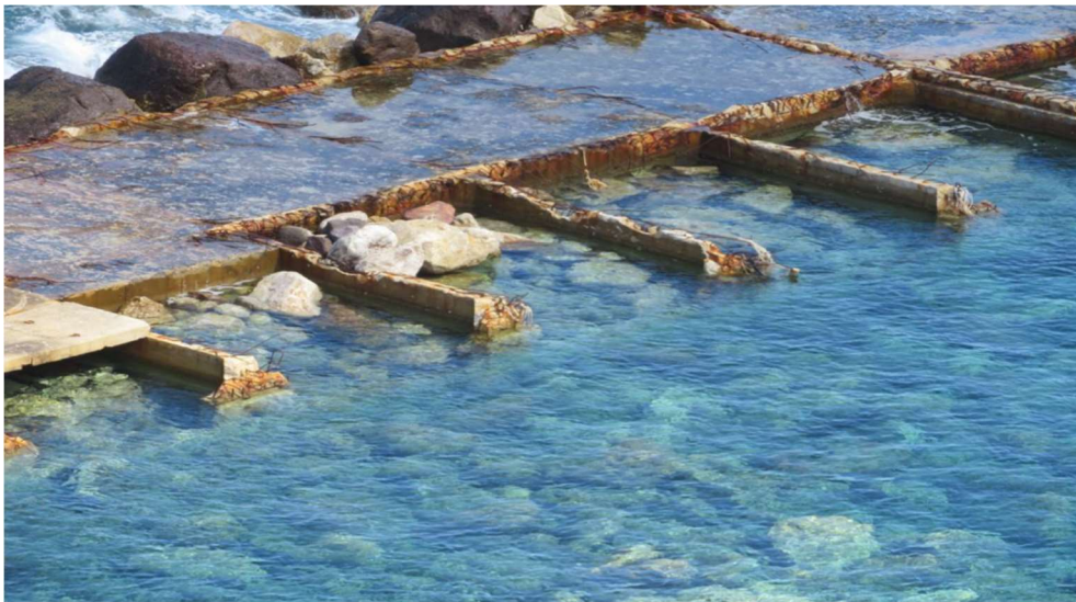
Figura 4 - Particolare delle celle dei cassoni cellulari antiriflettenti seriamente danneggiati dalle mareggiate
