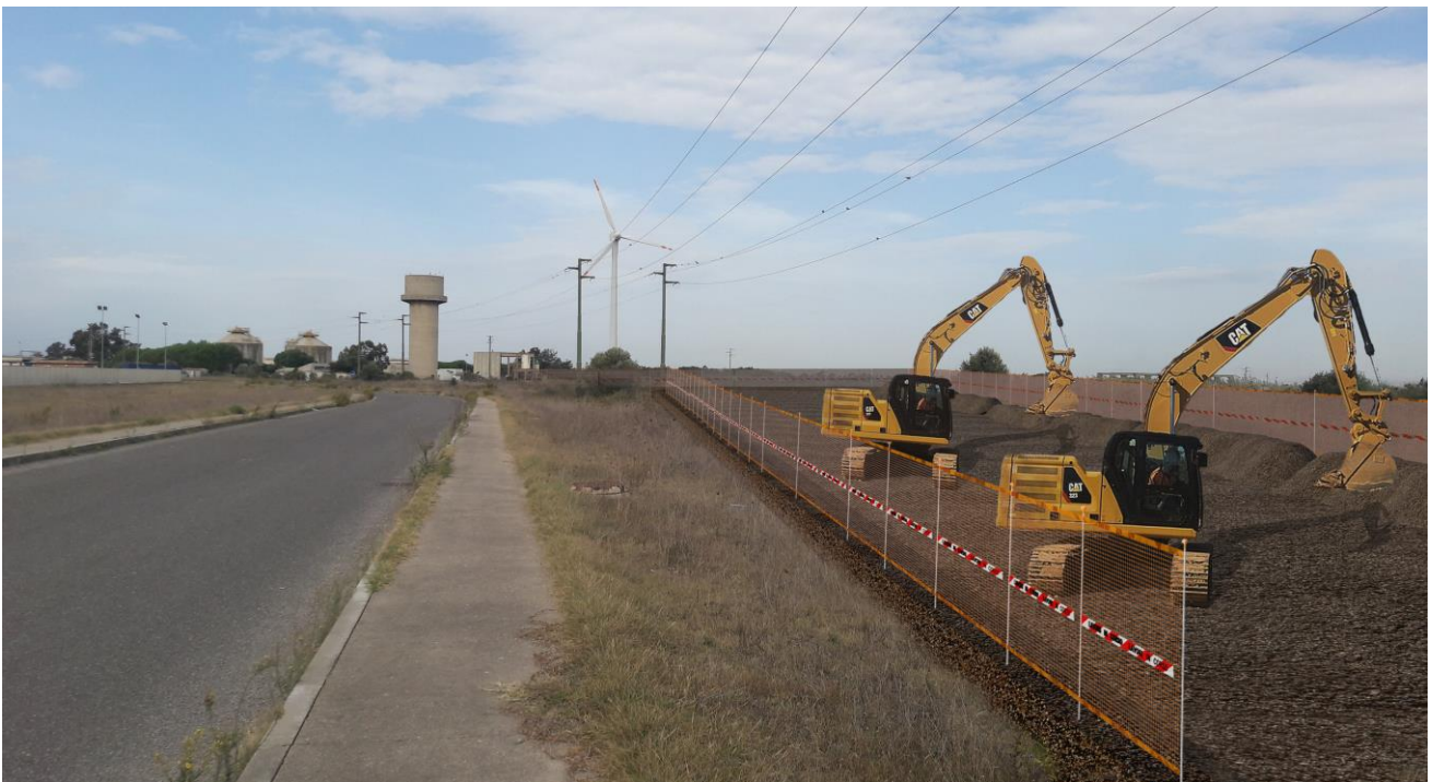
Fig. 3/H – Apertura dell'area di passaggio
