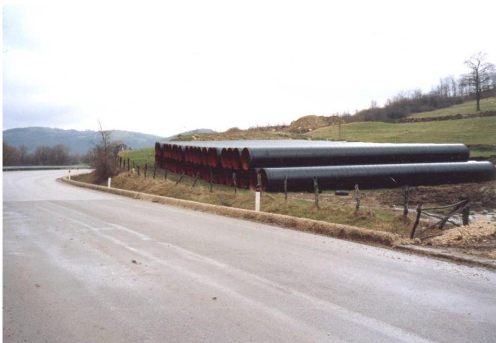
Fig. 9/A: Piazzola di accatastamento tubazioni
