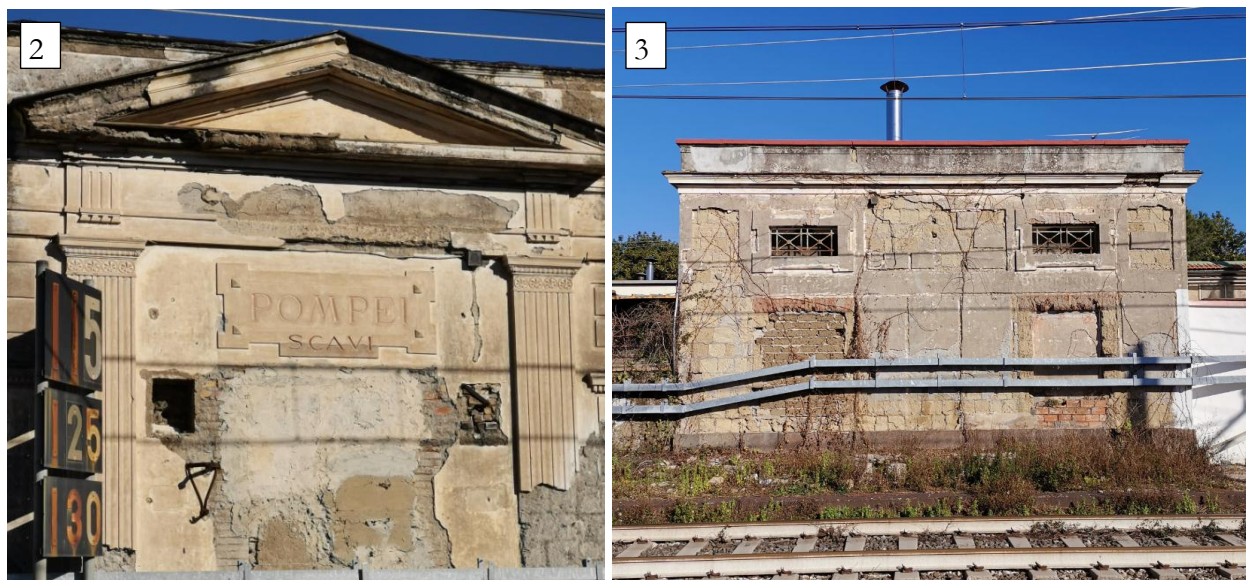
Figura 15: Stato di fatto fabbricati dell'antica Fermata Pompei Scavi – dettaglio del timpano del Fabbricato viaggiatori e del prospetto lato binari del locale bagni
