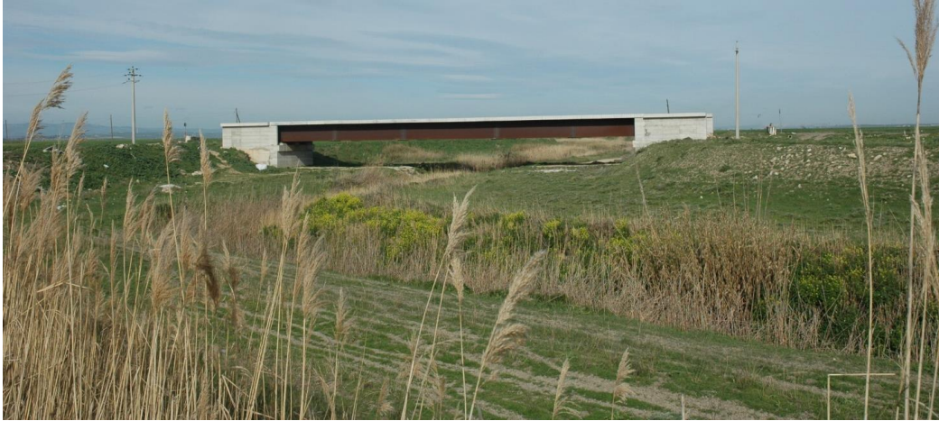
Fig. 12 – Ponte incompleto lungo la ex – SP 21 sul torrente Salsola
