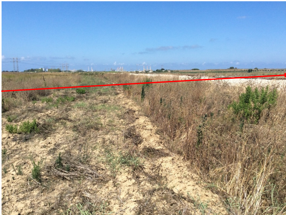
Foto 3 – Attraversamento in trivellazione spingitubo del Nuovo raccordo ferroviario Zona Retroportuale Brindisi-Rete RFI in costruzione
