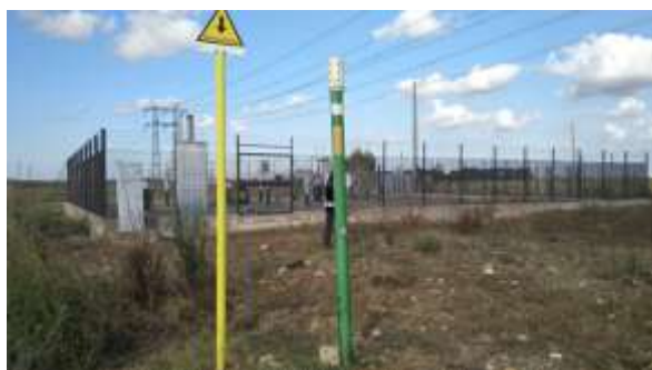
Foto 3 p.la 159 Impianto PIDI
