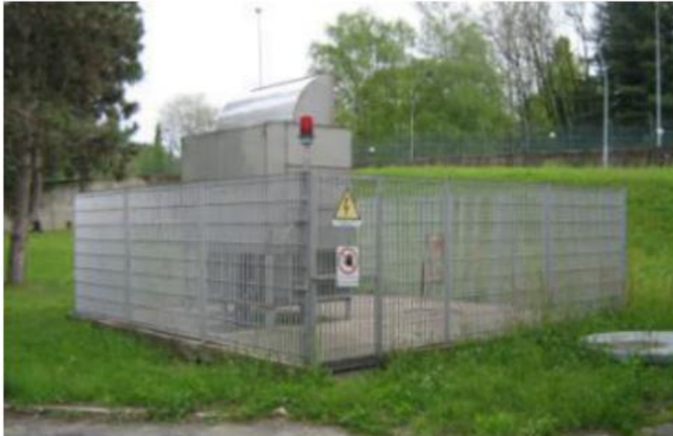
Figura 6-5: Edificio 85a - Reostato della sala Diesel
