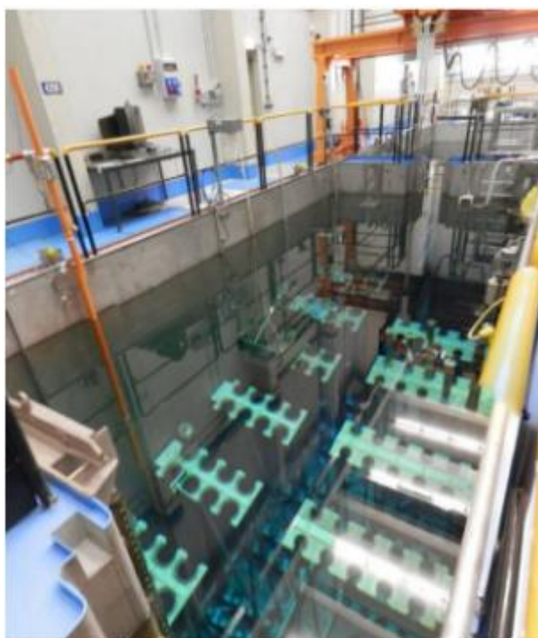
Figura 2-3. Panoramica della piscina del combustibile esausto
