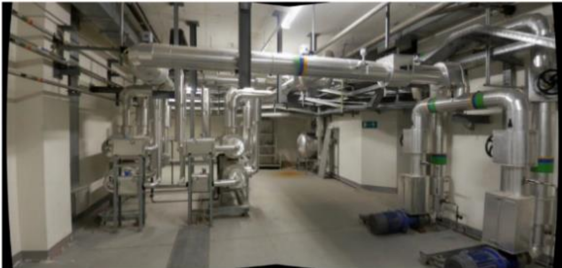
Figura 7-6: Edificio 86b – Laboratorio ETHEL, Vista sui sistemi WHRS (sala 2202)
