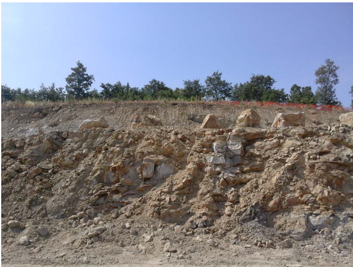
FAU/11 – Zona di cantiere con sito di monitoraggio sullo sfondo in alto
