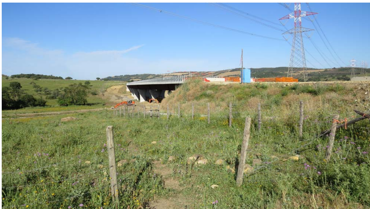
VEG28 – Visuale della zona di monitoraggio a margine delle operazioni di costruzione
