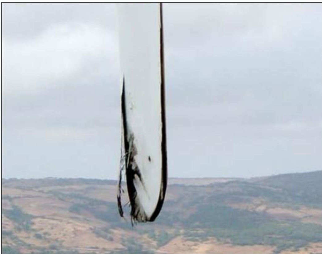
Estremità della pala danneggiata da fulminazione atmosferica
