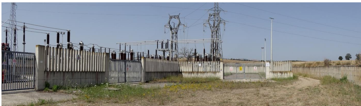
Figura 21-1 – Ingressi della stazione elettrica ERG di Forenza (sulla sinistra) e di quella di e-distribuzione (sullo sfondo)
