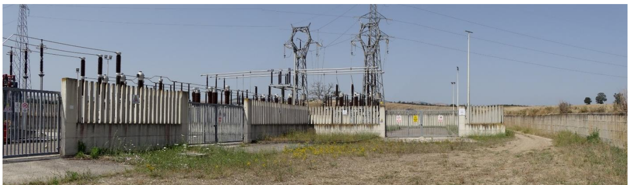
Figura 2.1-1 - Ingressi della stazione elettrica ERG di Forenza (sulla sinistra) e di quella di e-distribuzione (sullo sfondo)
