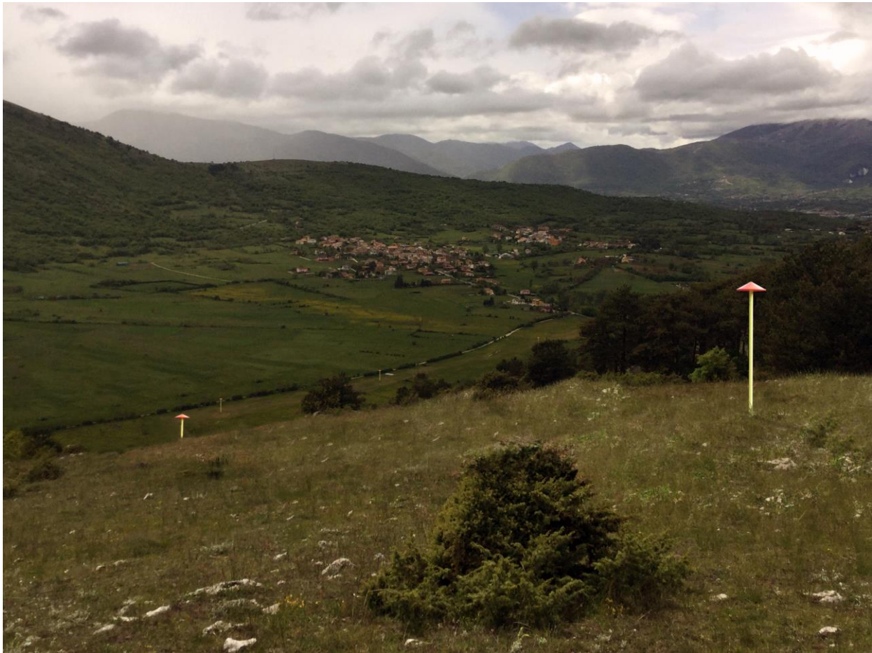
Fig. 5.6 - Termine dei lavori. Ripristini morfologici ed inerbimento eseguiti. Rimangono fuori terra solo i cartelli segnalatori.
