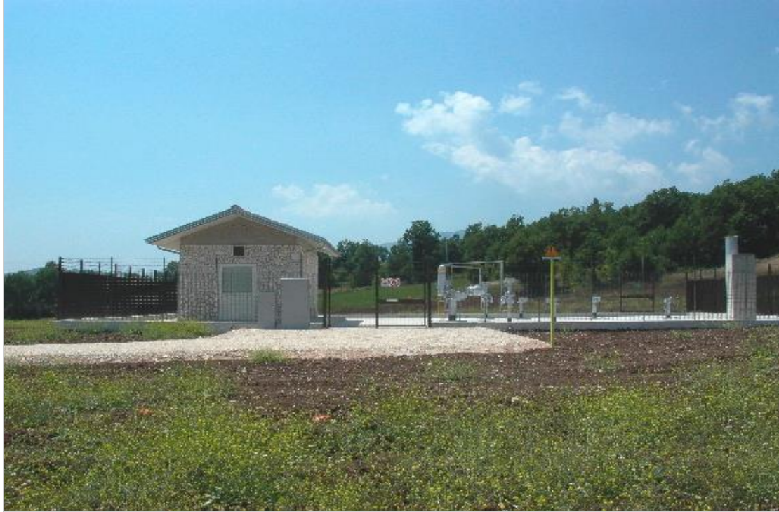
Fig. 6.37 - Punto di Intercettazione di linea (PIL).
