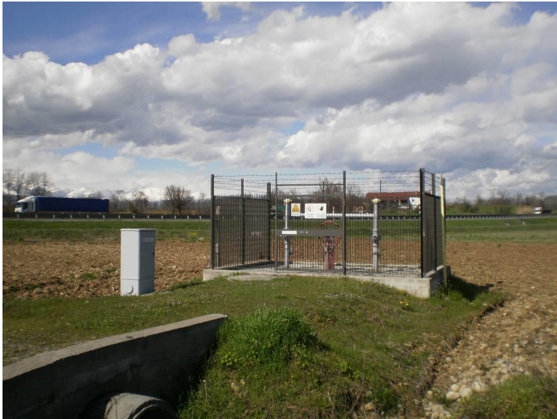
Fig. 6-4 - Esempio di impianto di intercettazione di linea PIL.
