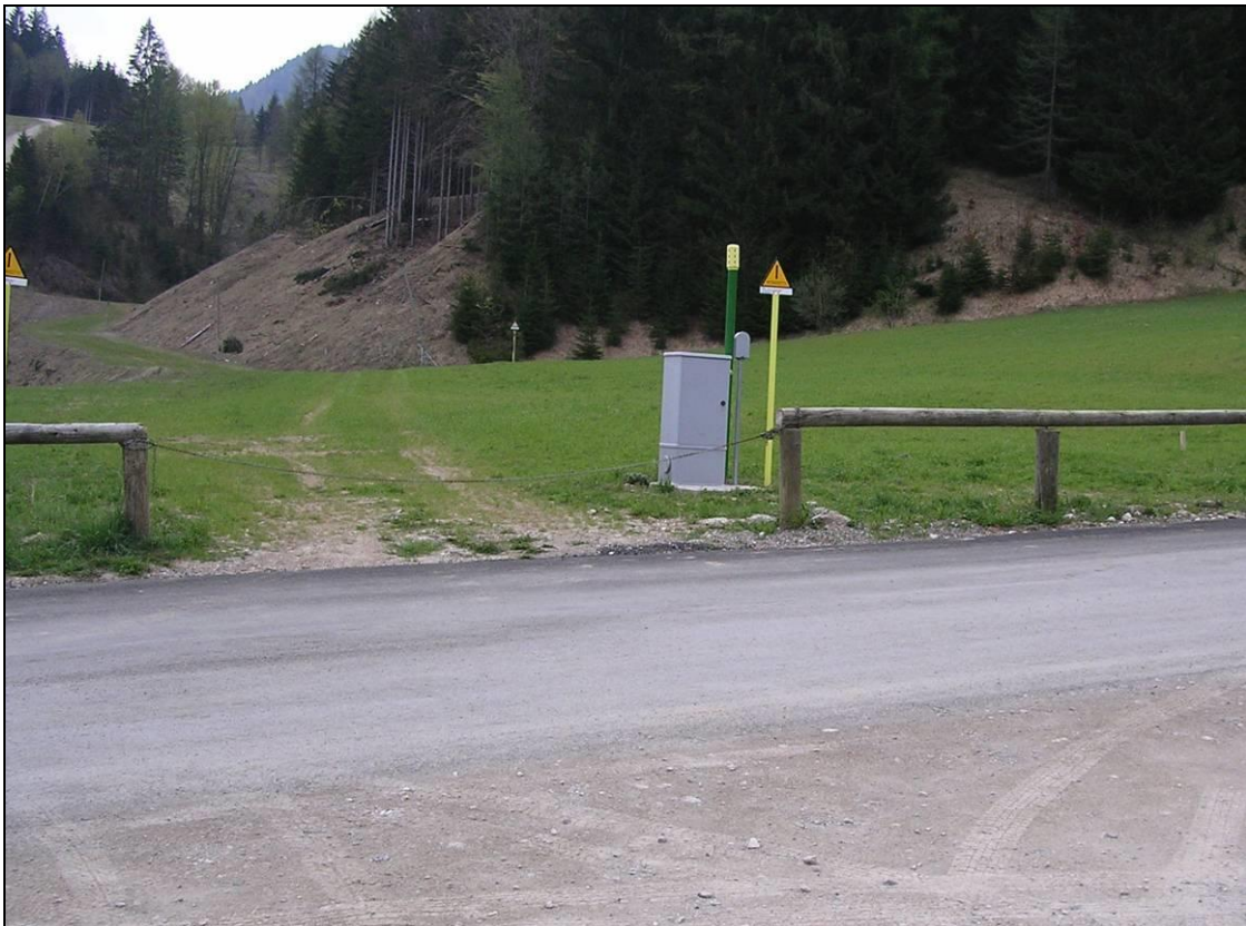
Fig. 6.36 - I cartelli segnalatori del metanodotto ed i tubi di sfiato posti in corrispondenza degli attraversamenti eseguiti con tubo di protezione.
