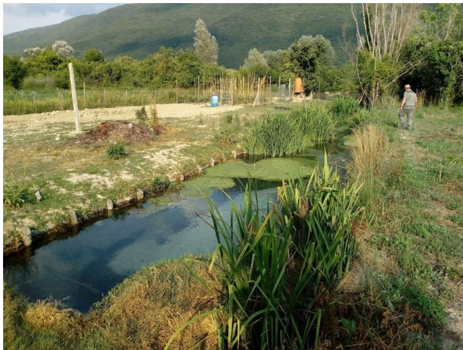
Figura 4-9: attraversamento del metanodotto in rimozione al KP 110+020 circa, cantierizzato nel 2017 e poi ripristinato solo con semplici palizzate spondali. La vegetazione acquatica e elofitica ha spontaneamente ricolonizzato l'alveo.
