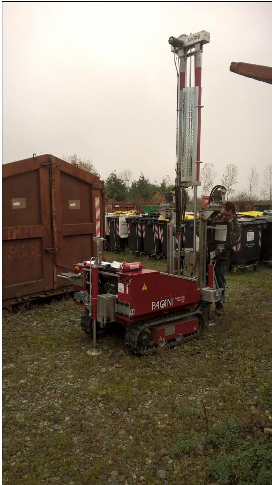
Penetrometro dinamico PAGANI TG-63 -100 Kn Centrale EGEA IN PROGETTO Comune di Alessandria PIAZZALE A.M.A.G. in fregio a Via Pasino e campo sportivo
