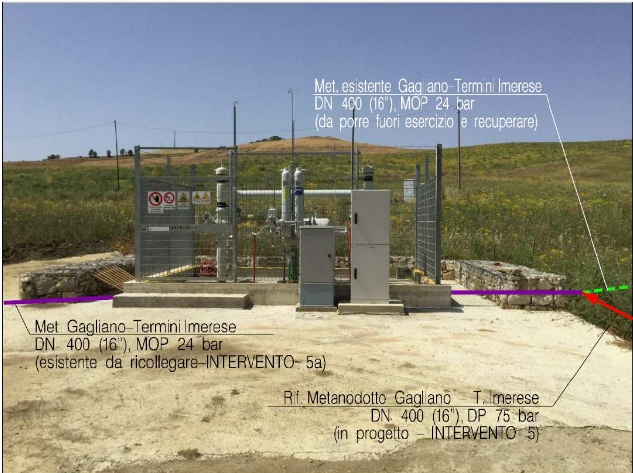
Figura 14 – Impianto esistente 45670/10.0.1 da ricollegare
