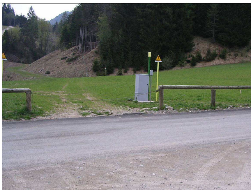
Figura 5 - I cartelli segnalatori del metanodotto ed i tubi di sfiato posti in corrispondenza degli attraversamenti eseguiti con tubo di protezione.
