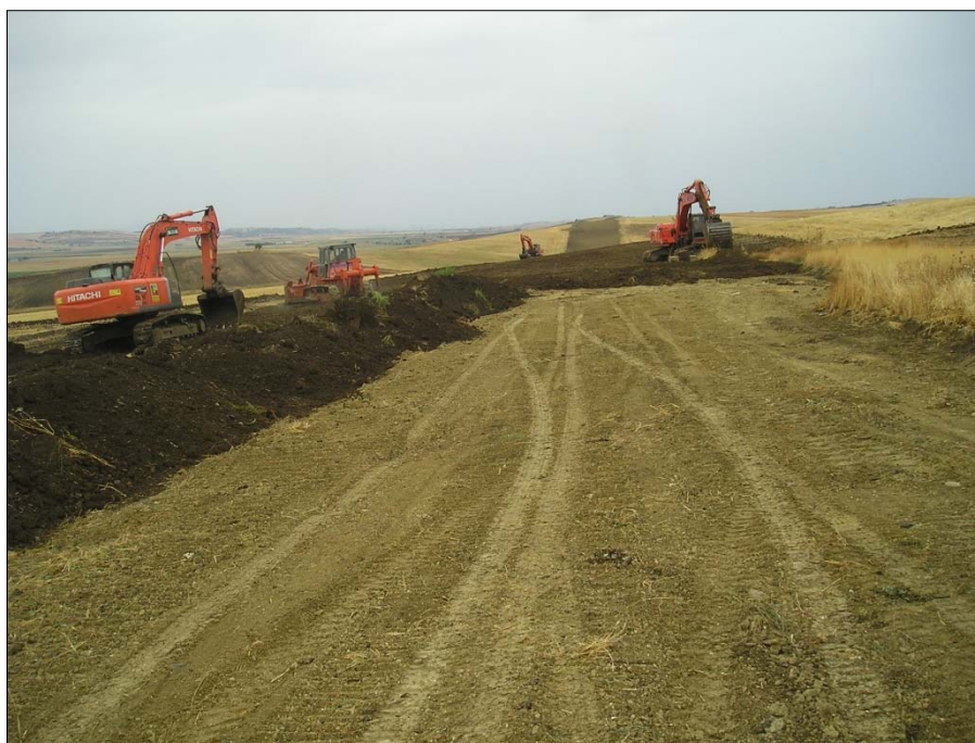
Fig. 1.3/B: Al termine dei lavori di posa con la trincea interrata, riposizionamento del top soil
