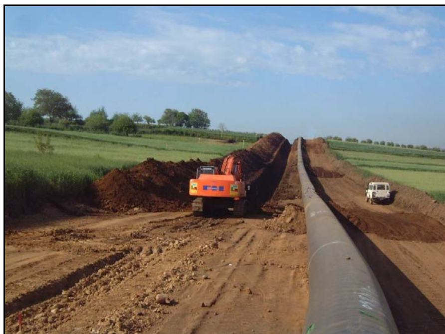
Foto 3.2/C: Scavo della trincea con la condotta già sul bordo scavo lungo la pista di lavoro (esempio di condotta con diametro superiore alla linea in progetto)
