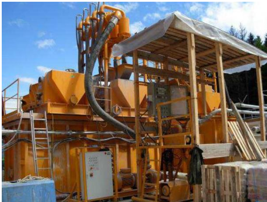
Fig. 7.1.10-G – Sistema di disidratazione
