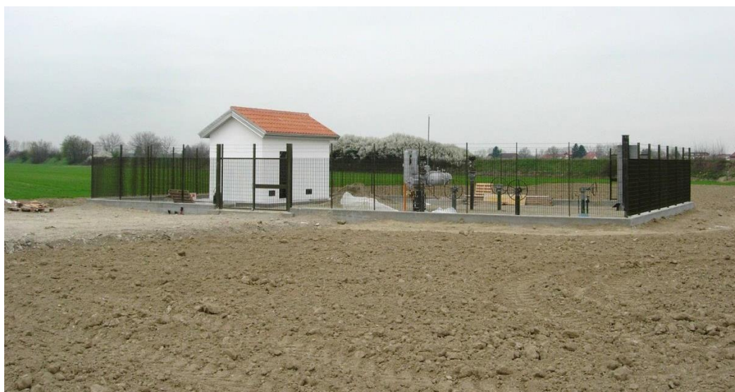
Fig. 2.5.6-A – Esempio di Punto di Intercettazione di Linea (PIL) telecontrollato.
