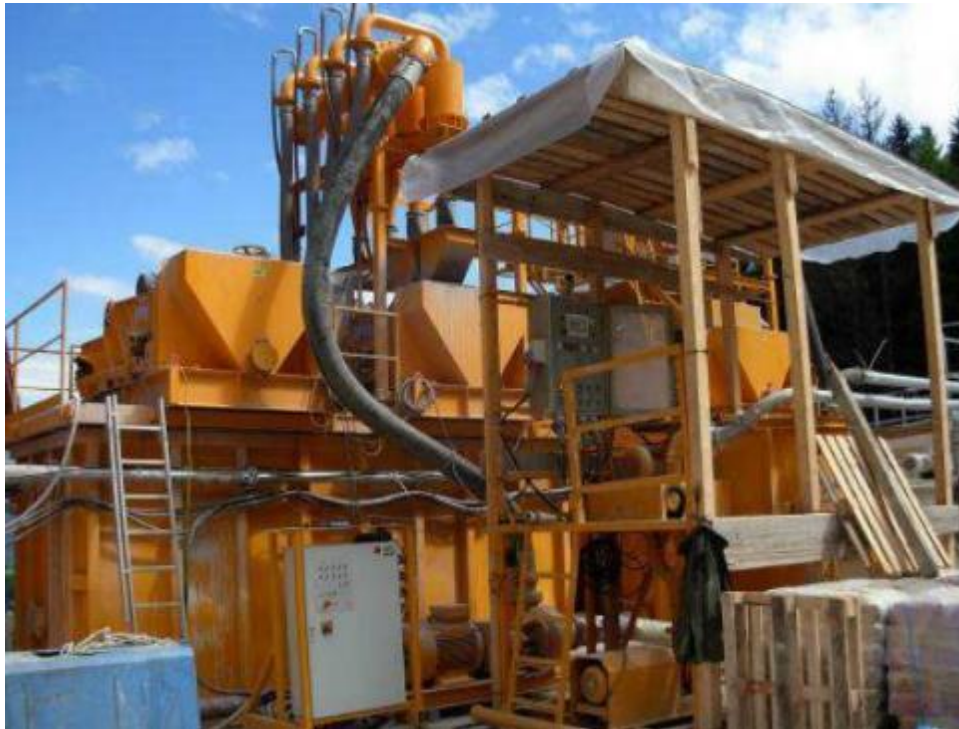
Figura 3-31 – Sistema di disidratazione
