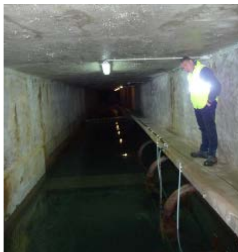
Foto 4: cunicolo sorgenti – prese di aspirazione pompe
